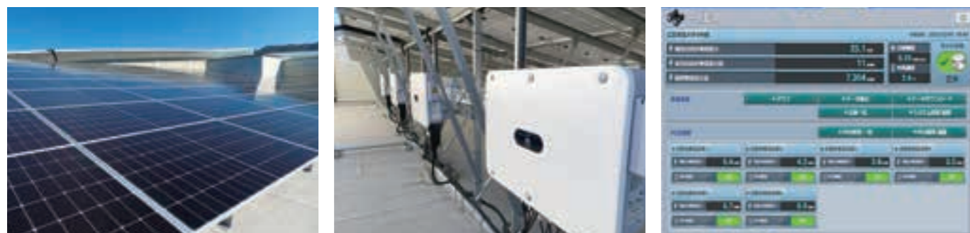
リアルタイムで発電状況をお知らせするモニター
